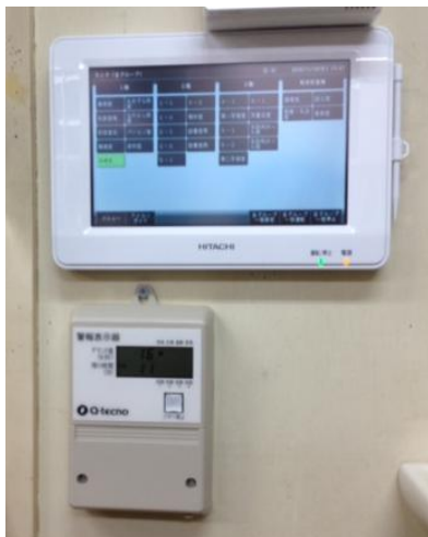
コントローラーとデマンド装置
